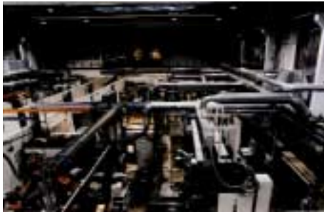
Blick in die Technikumshalle des IWS
